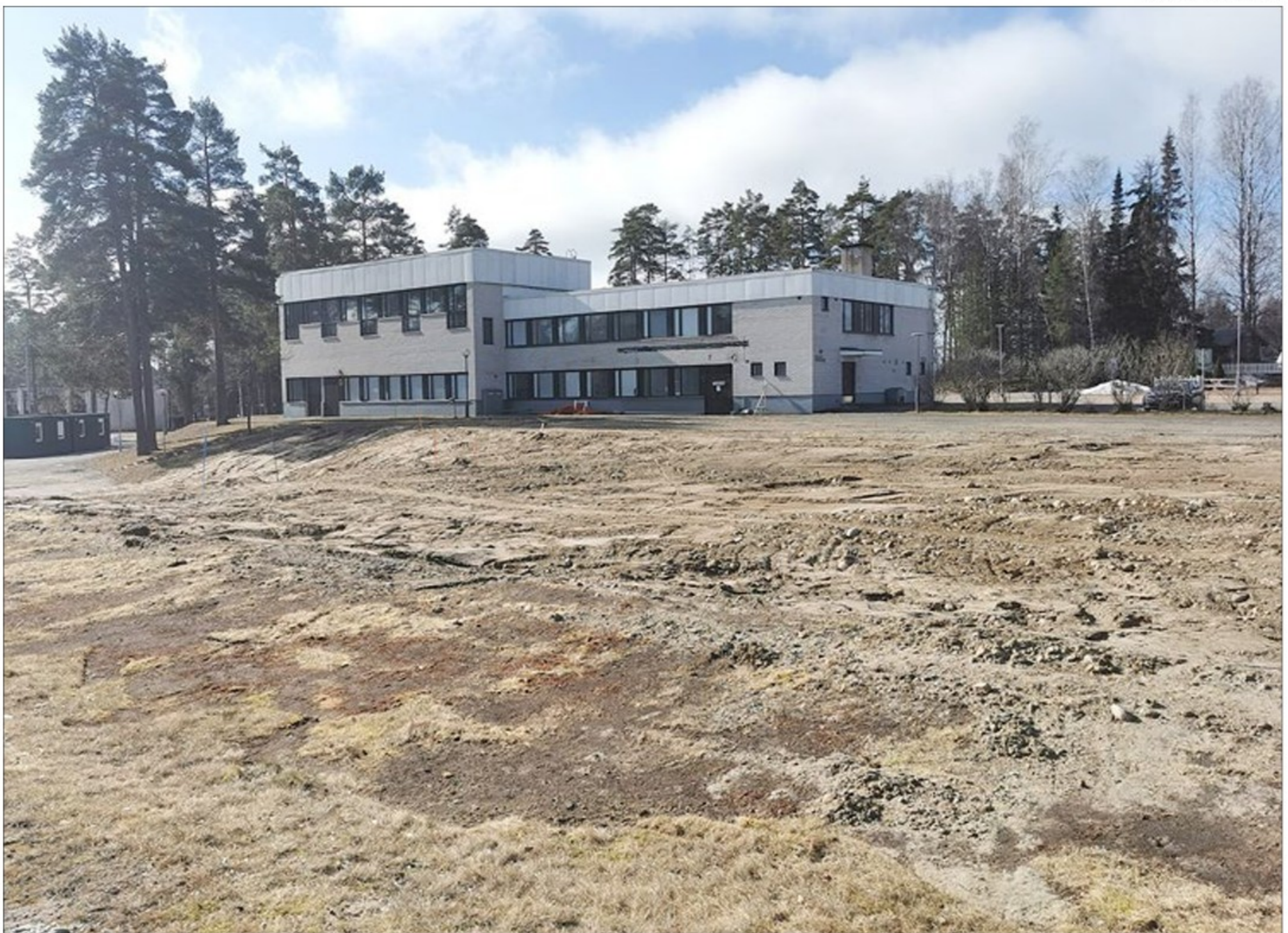
Pohvinrinteen vanhan koulukeskuksen keskirakennus on vielä pystyssä ja odottaa jo päätettyä purkamistaan. Keskirakennuksen ympärillä alkaa olla melko autiota. Nyt myös entinen ala-asteen siipirakennus on saatu juuri purettua pois.
